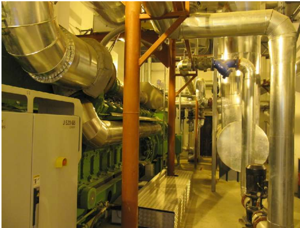
Fig. 5.2 Imagine din sala motoarelor, CET Vest Energo, detaliu cu un motor de 3 MW
